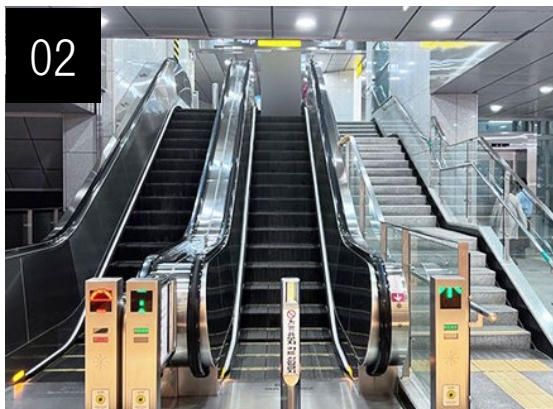
02 エスカレーターまたはエレベーターをご利用ください。
